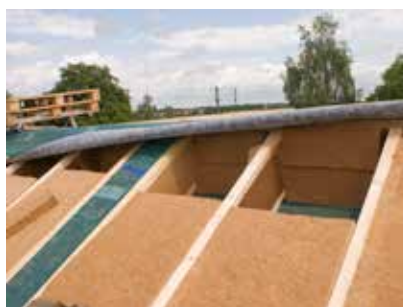
Pohled do izolační roviny střešní konstrukce. Předem izolované nosníky STEICO joist s izolací STEICO flex .
