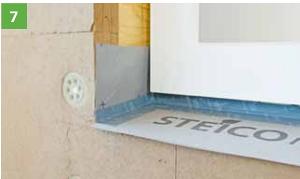
7 Vsazení izolačního klínu STEICOfix do ostění, stržení krycího papíru z lepicí pásky a přitlačení lepicí pásky STEICOmulti tape F.
